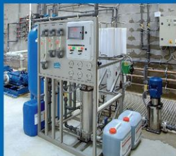
Estación de ósmosis.
