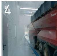
4 Primera zona de aclarado de alta presión alimentada por bombas de 75 cv.
