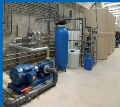
Una de las bombas de 75 cv.
